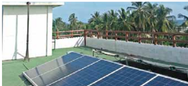
Autoprodutor con paneles solares instalados en el techo de una residencia
