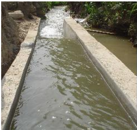
Foto 5 (izq.): Vertedero, medidor de caudal
