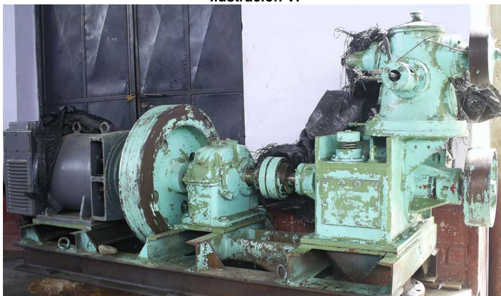
Equipo electromecánico (turbina de flujo cruzado) con multiplicador de velocidad adquirido por el Municipio de Sondor para la localidad de Tuluce.
