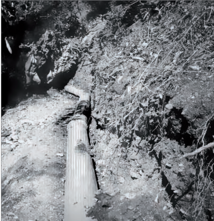
Figura 30. Canal de tubería
