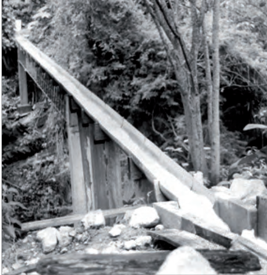
Figura 33. Pase de canal en arroyo
