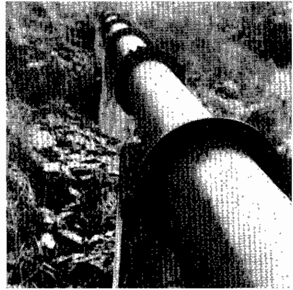
Foto 3.5: Tubería de presión de acero comercial. Unión con bridas.
